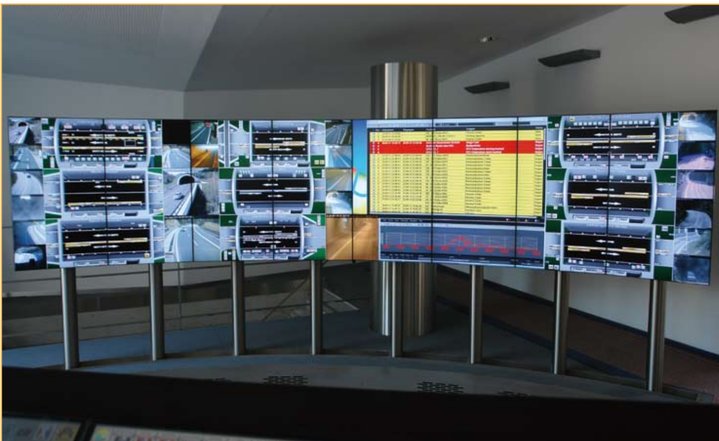
Elk van de vier grote displays in deze Oostenrijkse controlekamer voor tunnel- en verkeersbewaking is uitgerust met een gevoelig touchscreen oppervlak waardoor de operator intuïtief met de vingers de schermen kan bedienen.
